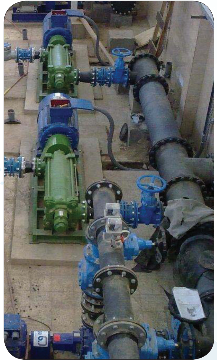
Lifting Pumps مضخات الرفع
