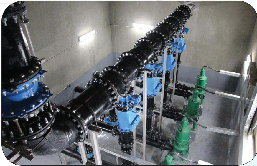
Sewage Pumps مضخات الصرف الصحي
