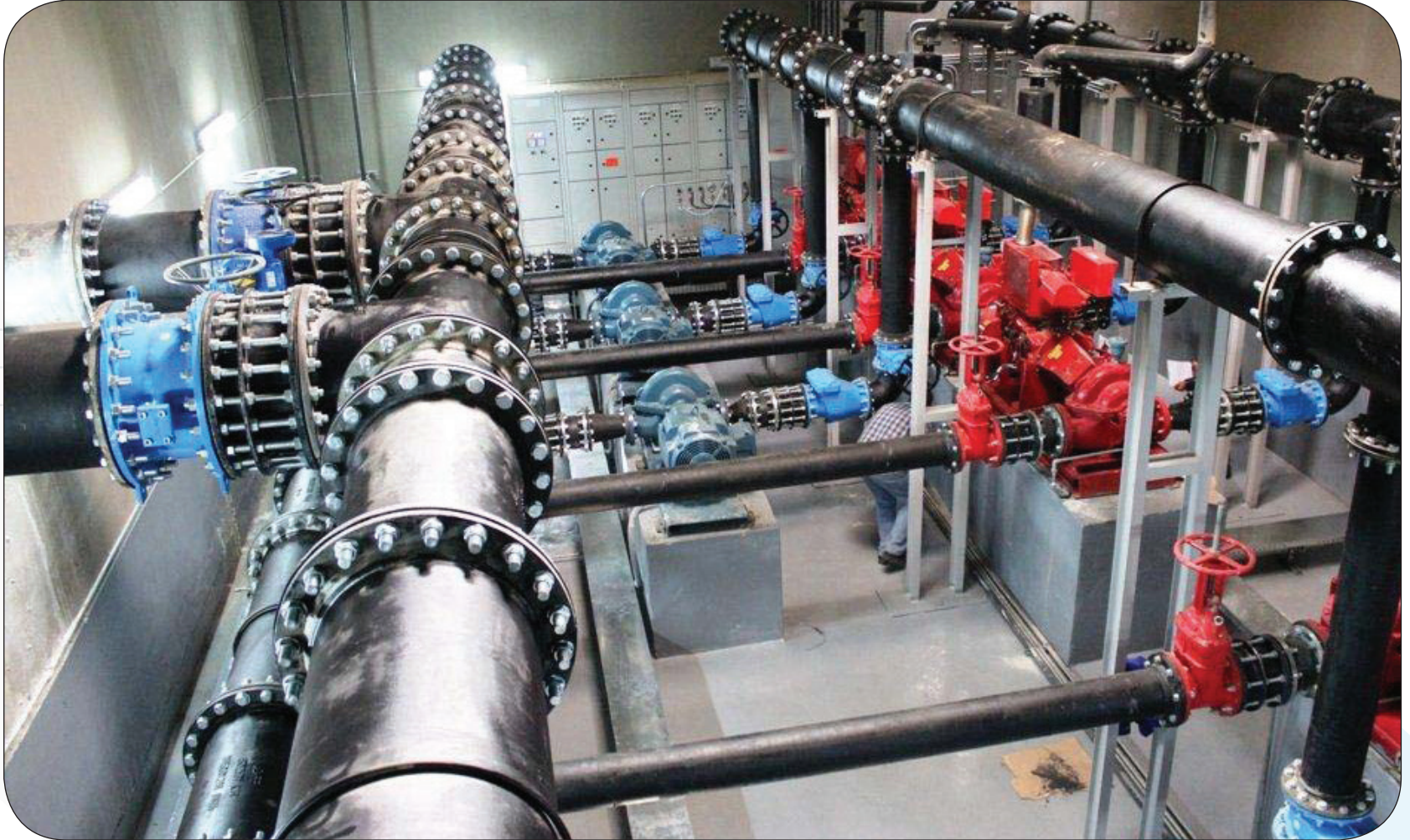
مضخات مكافحة الحريق Fire Pumps
